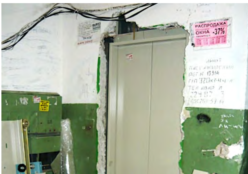
Рисунок 54 – некачественный монтаж дверей и створок дверей
