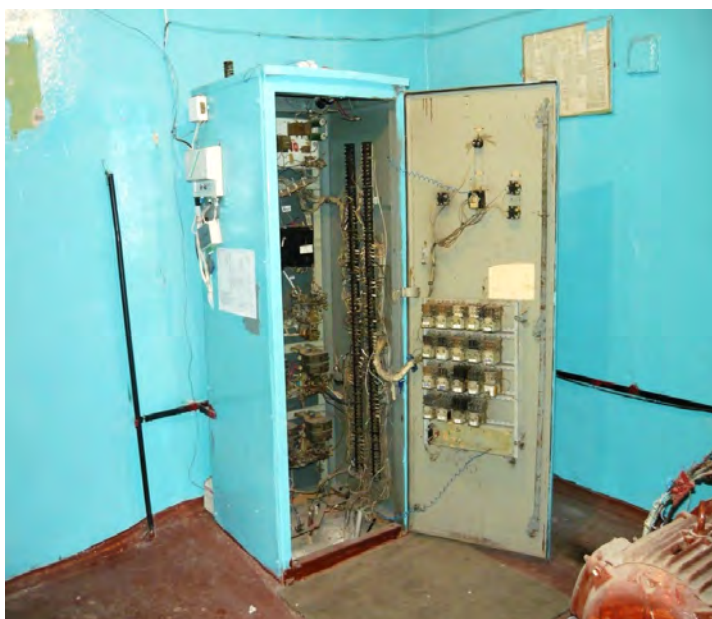
Рисунок 49 – шкаф управления до замены
